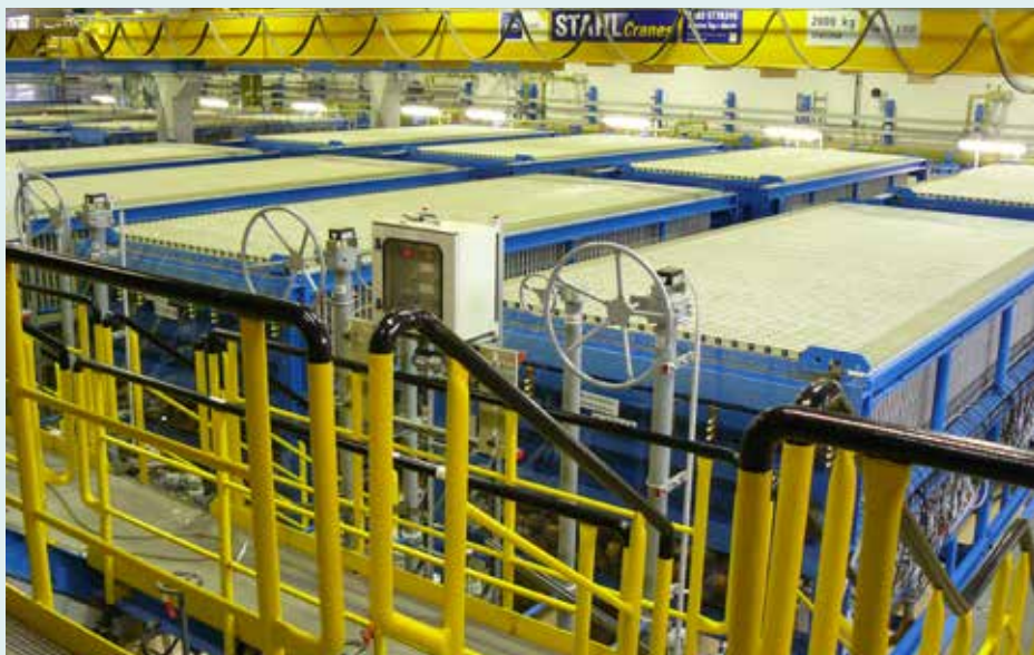
Производство хлора мембранным методом на заводе Vinnolit, Германия
