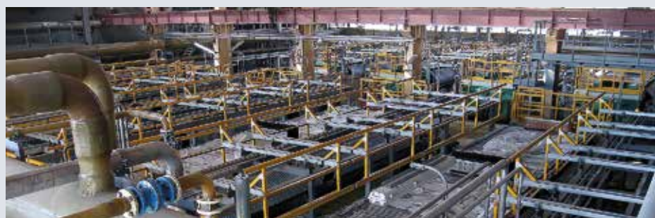
Цех электролиза ОАО «Саянскхимпласт»: оборудование и трубопроводы из стеклопластика
